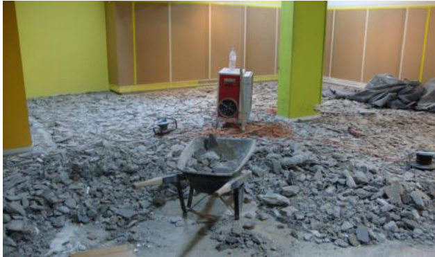
Rückbau des bestehenden Unterlagsboden um Platz zu schaffen für den Einbau des neuen schwingenden Unterlagsboden.
