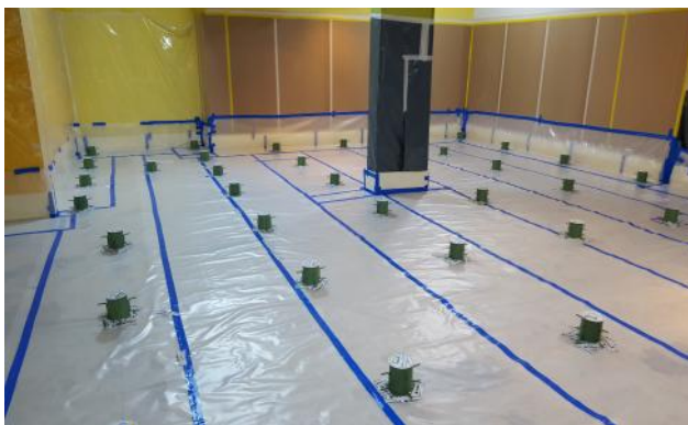
Die Federgehäuse sind gesetzt und die gesamte Lagerfläche ist mit einer dicht verklebten, zähen Trennfolie geschützt. Die Lagerung ist vorbereitet für das Verlegen der Bewehrung und Betonieren des neuen Schwingbodens.
