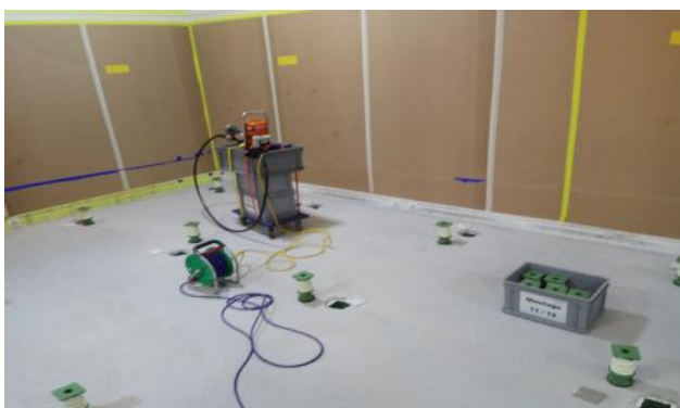
Nach dem Aushärten des Betons werden die Randstellstreifen entfernt und die Feder-elemente in die Gehäuse gesetzt. Durch das Spannen der Feder-elemente mittels Hydraulik-Werkzeug wird der gesamte Boden angehoben und schwingt frei auf den tiefrequent abgestimmten ISOMATIC-G Federn.
