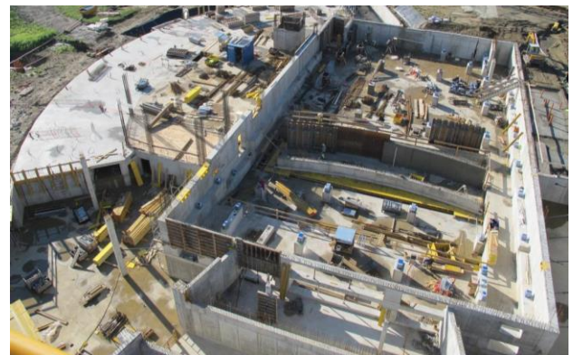
Übersicht über die gesamte Baustelle mit versetzten Stahlfederelementen. Im Vordergrund sichtbar die Vertiefung für den Orchestergraben.
